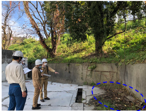
写真 3-1 361-T-006 工場内ひな壇部染出し（青破線）の状況
