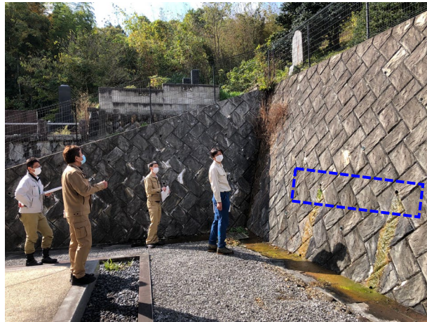
写真 3-2 361-T-007 社殿裏の水抜き穴（青枠破線）からの出水の状況
