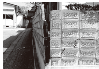
危険なブロック塀の例
