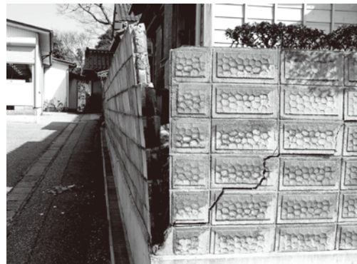
危険なブロック塀の例 (一財)消防科学総合センター http://www.isad.or.jp
