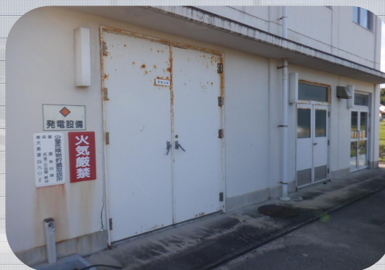
自家発電設備
