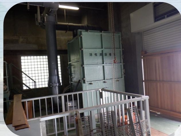
活性炭吸着塔
