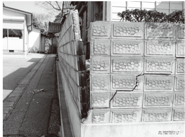
危険なブロック塀の例 出典:(一財)消防防災科学センター「災害写真データベース」
