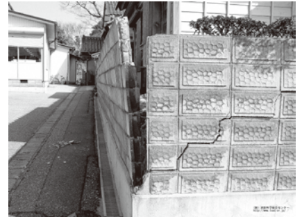
危険なブロック塀の例 出典：(一財)消防防災科学センター「災害写真データベース」
