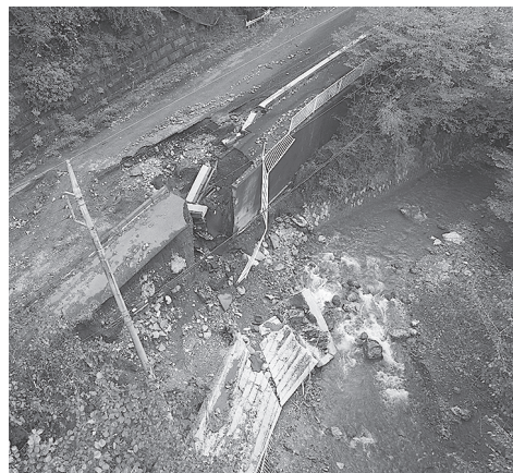
崩壊した生川沿いの町道
