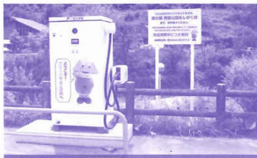
EVスタンド 実証試験中は無料で充電可能
