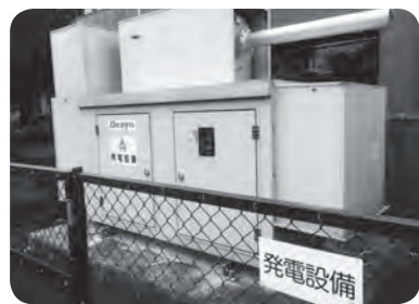
非常用発電設備（庁舎用）
